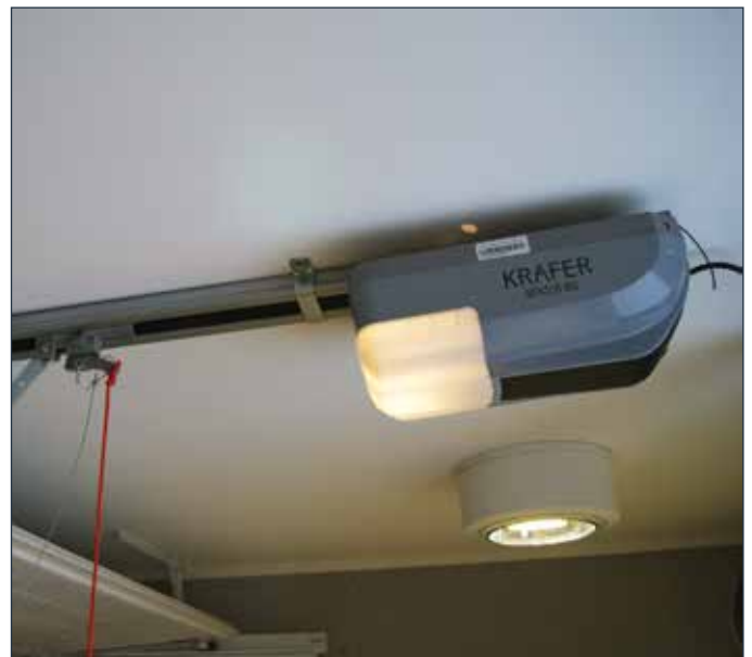
Ferdig montert motor.
