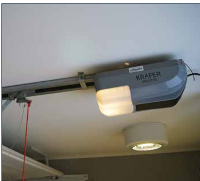
Ferdig montert motor.
